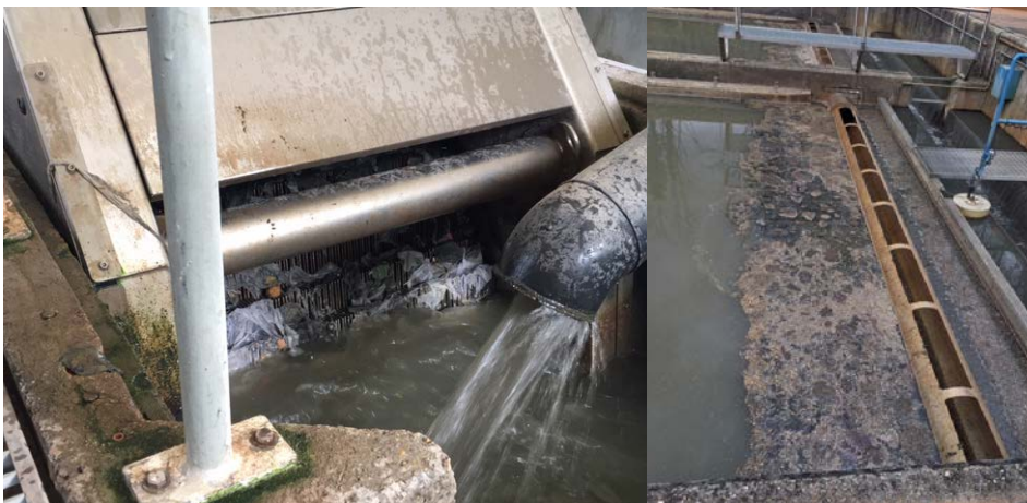
À gauche, à la toute première étape du traitement des eaux, apparaît un grand nombre de lingettes, qu'il est pourtant totalement interdit de jeter dans les toilettes. À droite, les graisses, qui sont pourtant également interdites, constituent une bonne partie de ce que la station doit traiter.
