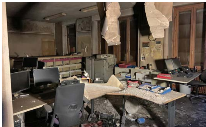
Des dégâts importants ont été constatés suite à l'incendie du secrétariat du collège de l'Esplanade.
